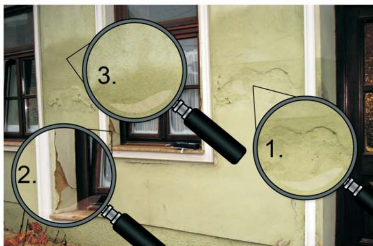
Foto: Typische Symptome von aufsteigender Bodenfeuchte: 1.) Anstrichschäden durch Salze, 2.) Putzabsprengungen 3.) Feuchtefleckenbildung
